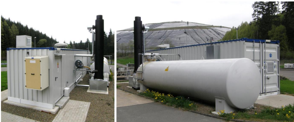
Abb. 3: Umkehrosroseanlage (max.160 m 3 /d) auf der Deponie „Alte Scheune“ in Deutschland inkl. Strip-Turm und Säurespeicher-Tank.
