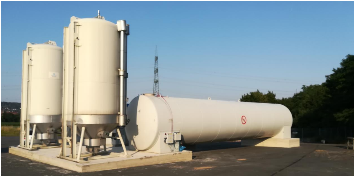
Abb. 5: Aktivkohleadsorptionsanlage auf der Deponie Stockstadt für die Behandlung von 30-100 m 3 /d Deponiesickerwasser.
